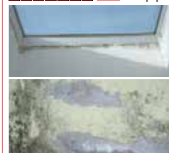
plíseň na okně
